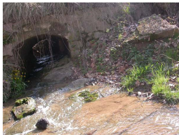
Figura 26: La riera de Perafita aigua avall de la Roca del Mill (L115) la primavera de 2009.
