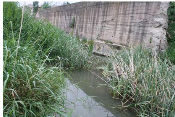
Figura 16. Riu Meder al nucli urbà de Vic (Te2) on el bosc de ribera hi és inexistent i tot el tram està canalitzat i formigonat.
