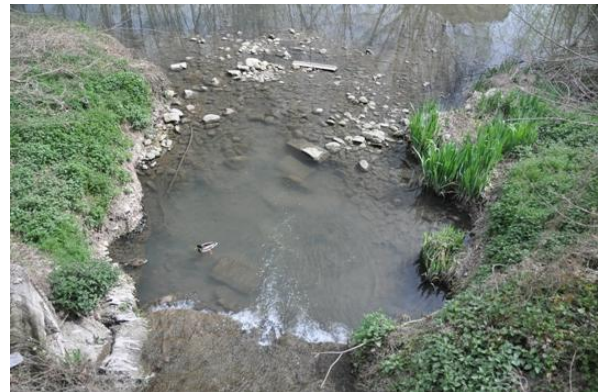
Figura 21. Detall del sobreexidor del carrer Sant Martí (riu Ter a Manlleu), amb problemes de fuites d'aigua residual del clavegueram.
