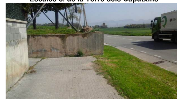
Vorera sense continuïtat a la ctra. de la Roda
