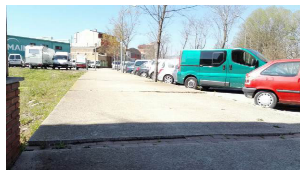
Vorera en mal estat av. dels Països Catalans
