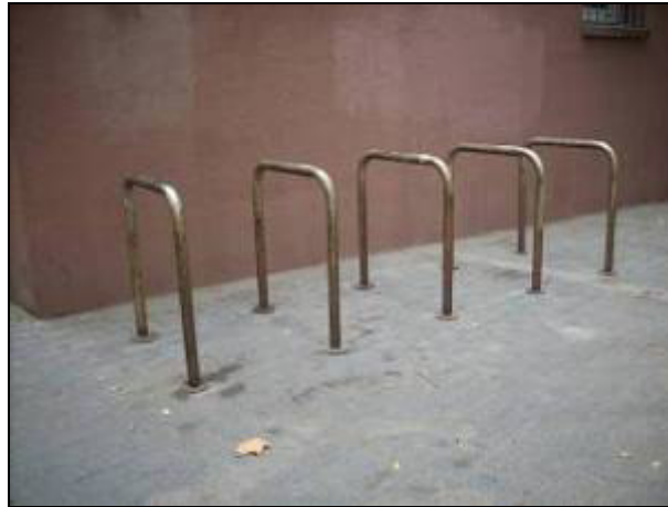
Figura 60: Aparcabicis con soportes oxidados (BACC)
