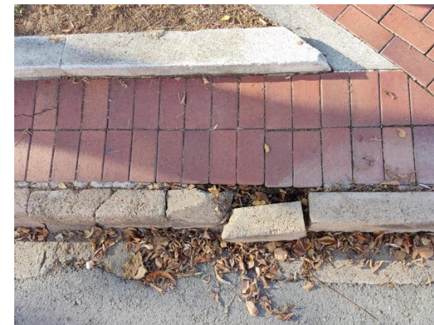
Peça de vorada trencada al lateral de la plaça
